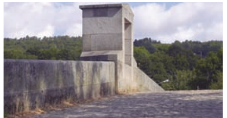
Arriba, dúas imaxes da ponte e, abaixo, a fornela situada no medio
