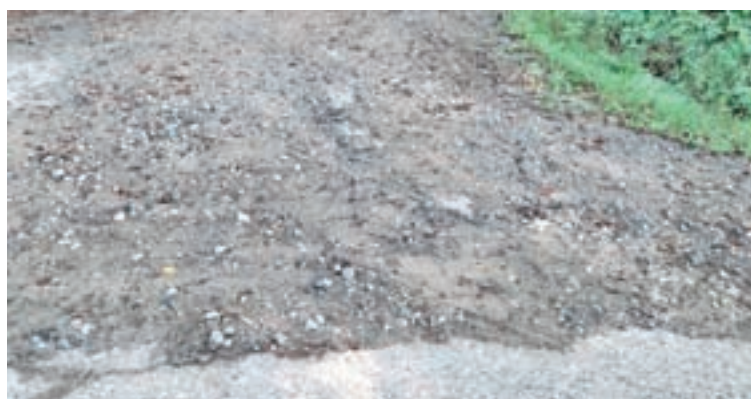
Estado no que se atopa a pista de Albán a Alvaredo
